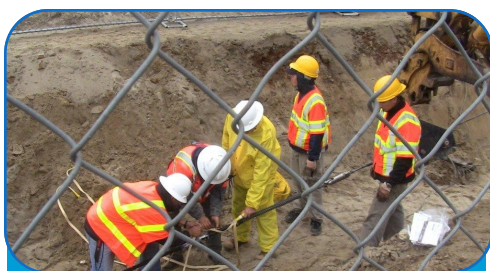
OOI Cable Landing
